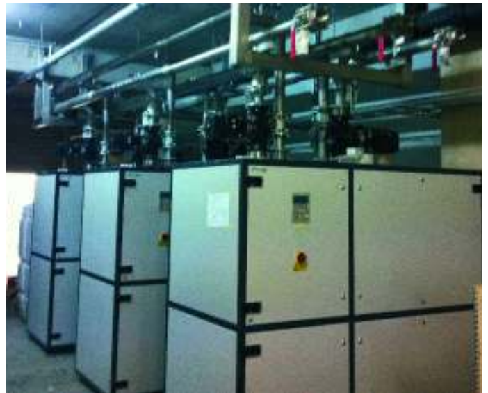
Abb. 4: BM Green Cooling Modulkaltwassersätze mit Siemens S7 Regelung und Spezialbeschichtung gegen Korrosion
