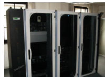
Bild 2: 3 Racks mit 2 SideCoolern
