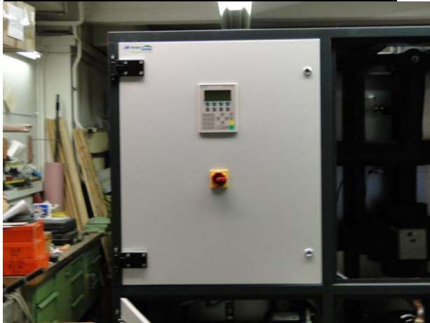
Bild 2: Siemens S7 Regelung integriert in jeden einzelnen Klimaschrank
